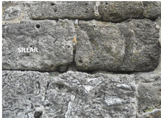
Ilustración 7 Detalle de junta sin consolidar.
